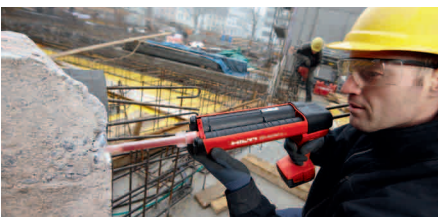
5 Post instalado de varillas de refuerzo estructural: conexiones de concreto a concreto.
